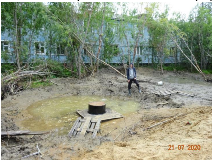
Подтопление в районе ул. Чапаева, 21 (пункт наблюдений 89-1210-0001-665)
