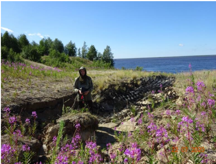
Овражная эрозия в районе газопровода (пункт наблюдений 89-1210-0001-196)
