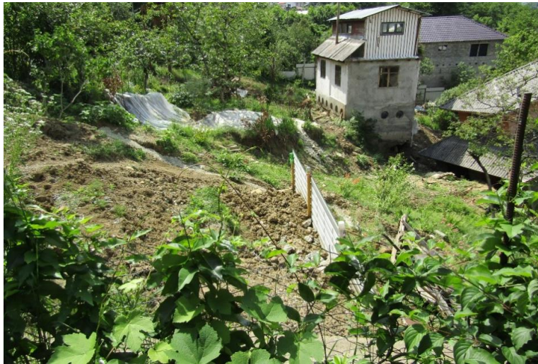
Рис. 22. Общий вид на оползень в районе дачных участков №№ 16-19 (дом № 18 деформирован, дом № 19 разрушен)
