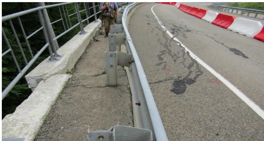
Рис. 15. Сочинский полигон. Краснополянский участок. Участок деформации автодороги на правом борту Черного ручья.
