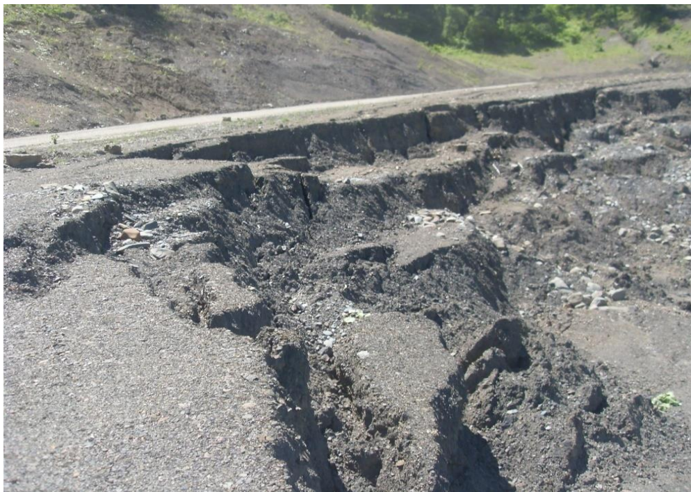
Рис. 4. Активный оползень в низовом откосе автодороги с. Итум-Кале – с. Ведучи, км 3,1, Чеченская Республика
