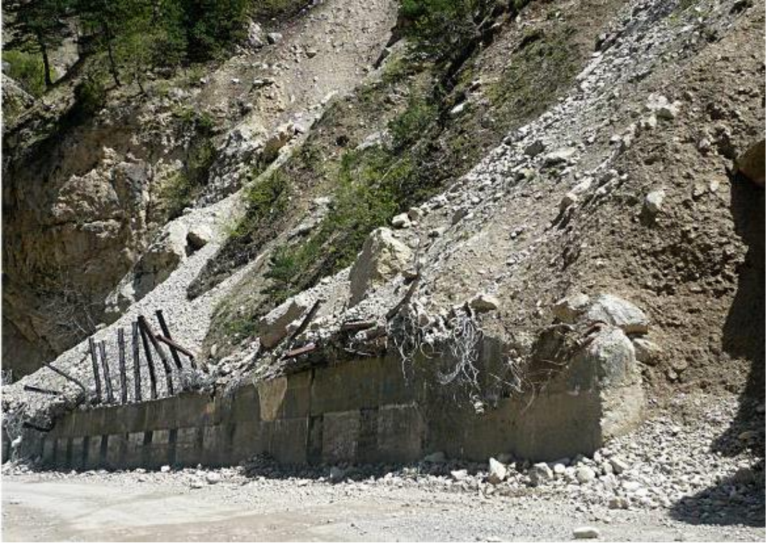
Рис. 7. Деформация подпорной стенки на участке «Святой Георгий», автодорога Чикола-Мацута
