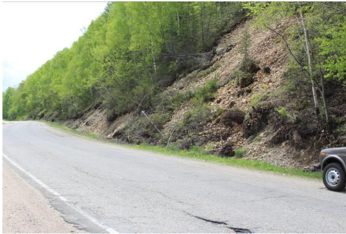
Антоновский. Активизация обвально-осыпного процесса на участке 235,85 км автодороги Осиновка-Р. Пристань по состоянию на 27.05.2020 г.
