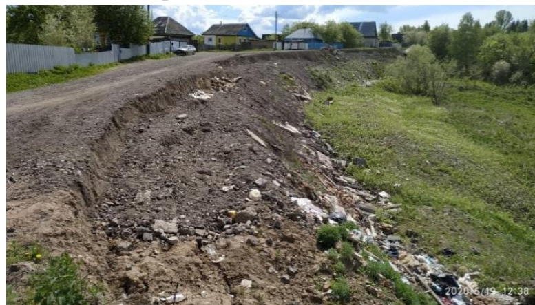
Рис. 14. Оползень п.н. 66-1210-0755 (Участок Ашинский, ул. Набережная)
